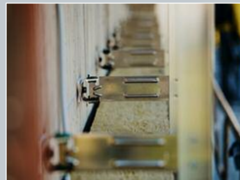
Die Basis für die vorgehängte hinterlüftete Fassade bilden Außenwände aus 200 mm starkem Stahlbeton. In diese wurde zunächst die Aluminiumunterkonstruktion thermisch entkoppelt fixiert.
